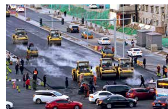
全长6.6公里的化工路改造工程最后一次铺设沥青，作为朝阳区重要的拥堵路段和重点民生工程之一，即将竣工通车。(李晓晨/摄)
