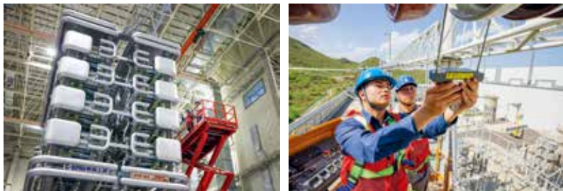
运检人员进行设备检查
