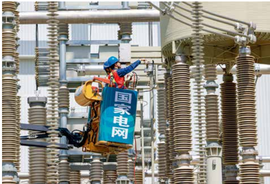
运检人员进行设备电阻测量
