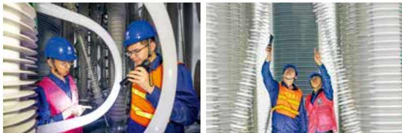
运检人员进行设备投运前检查
