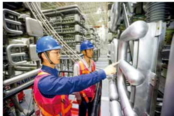
运检人员在阀厅进行阀塔带电前检查
